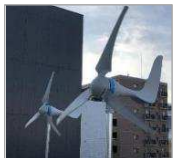
風力発電 (東京本社設置)
